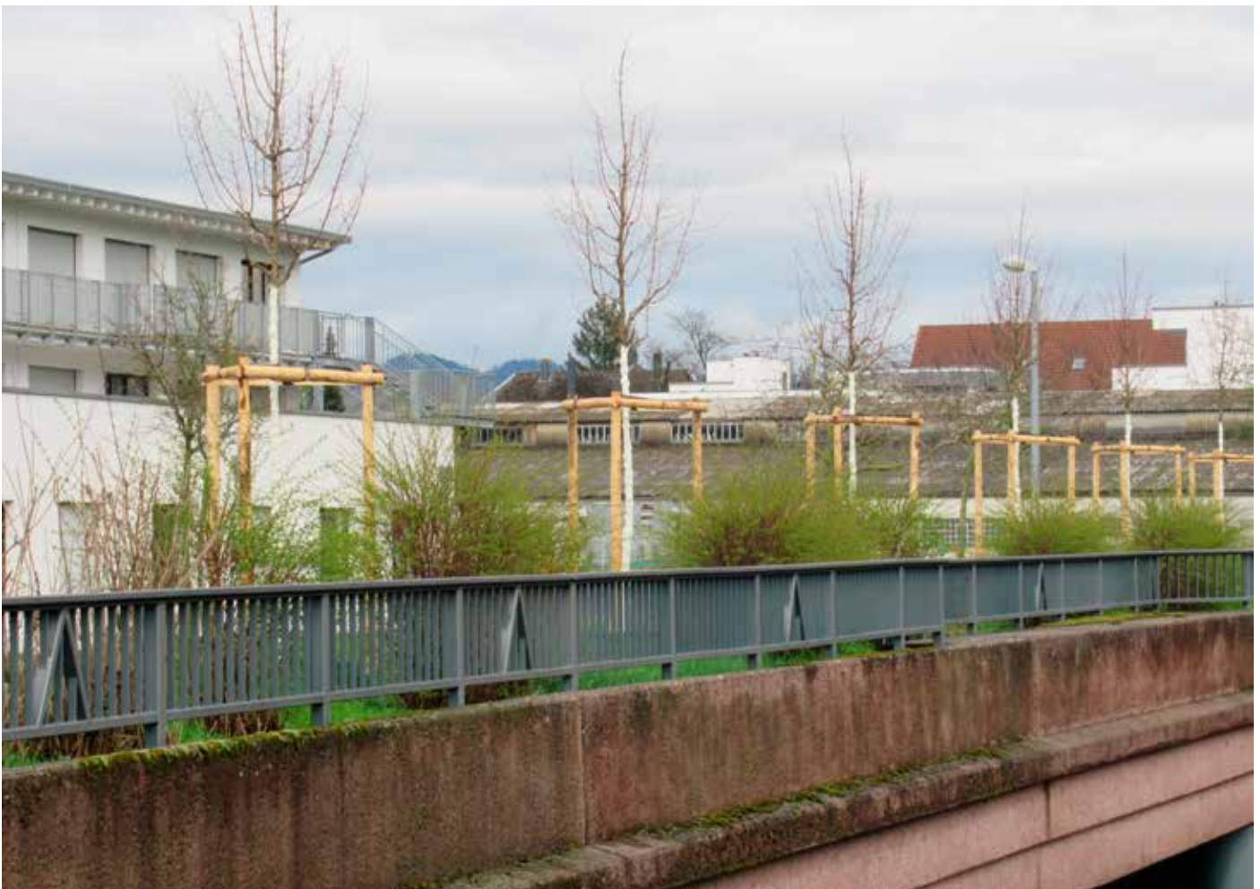
Direkt auf dem Damm über der B 31 wurden Bäume gepflanzt, die allerdings keine Tiefwurzler sein dürften.
